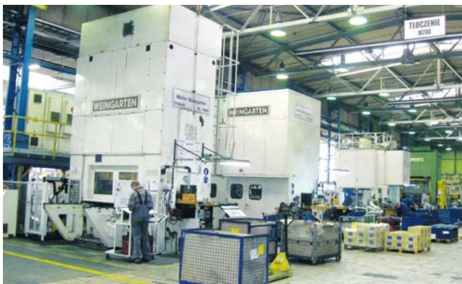
ThyssenKrupp Sofedit Poland
